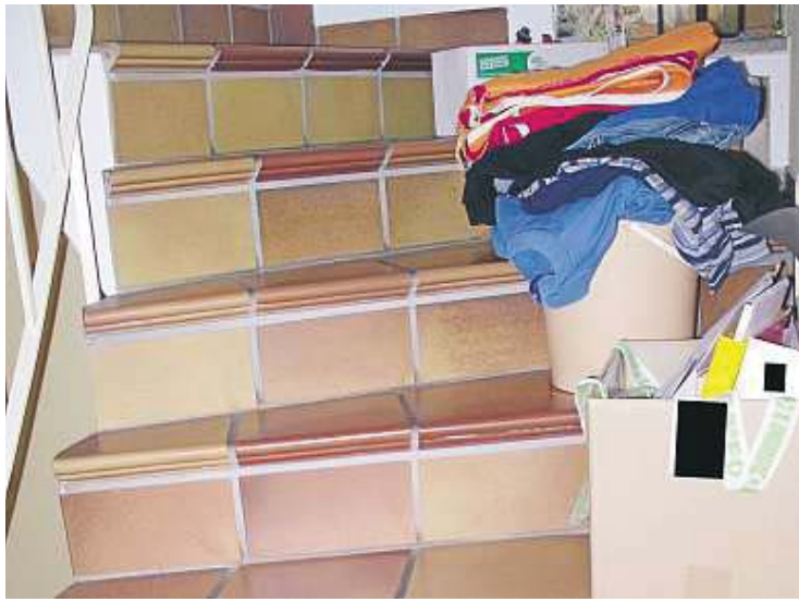
Auch voll gestellte Treppenaufgänge stellen eine Gefahrenquelle dar.
